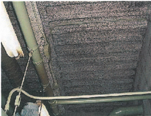
天井断熱材 天井、壁吸音材
