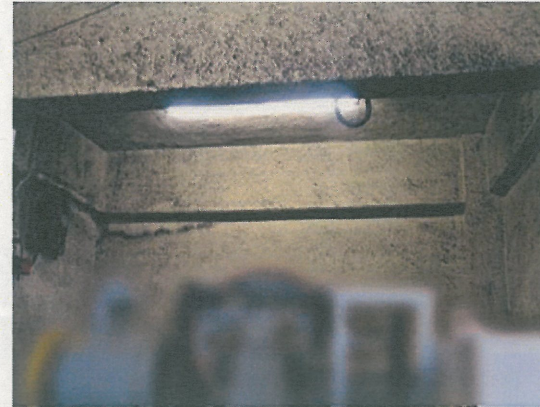
機械室 吸音材
